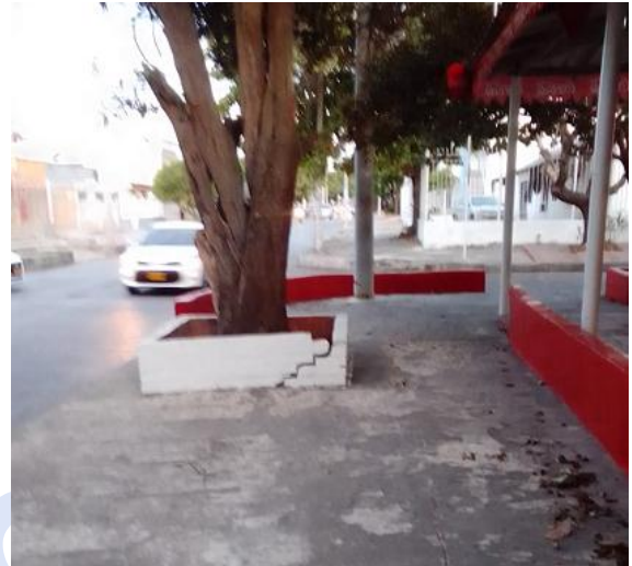
Imagen 2, Destrucción de zona aledaña
