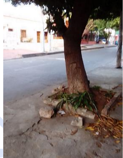
Imagen 1, Árbol destruye piso.
